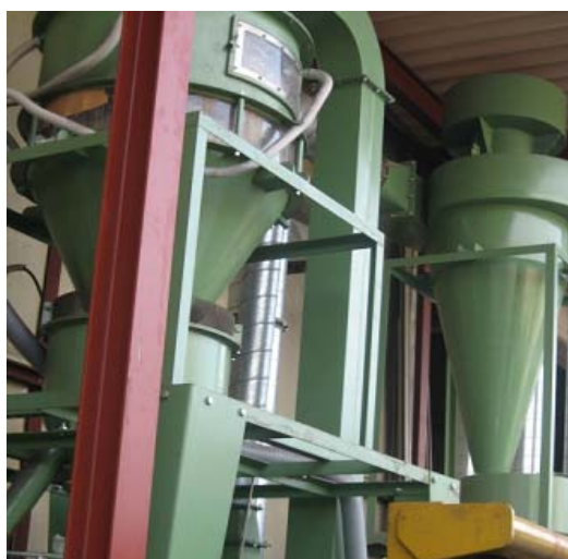
リサイクル設備
